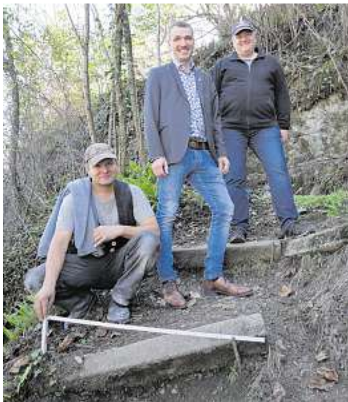
Thomas Schmider, Bürgermeister Thomas Geppert und Dieter Jehle begutachten die Schäden am Aufgang zum Stuckhäusle
