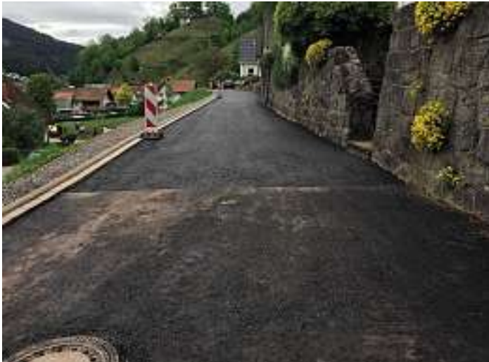
Sanierte Straße „Auf er Kanzel“ ohne Feindecke
